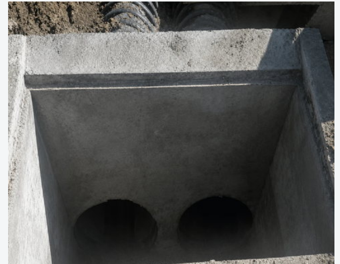
CÁMARA DE HORMIGÓN Y CANALIZACIONES
