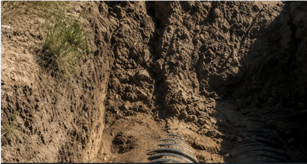
CANALIZACIÓN DE DRENAJE ENTERRADA
