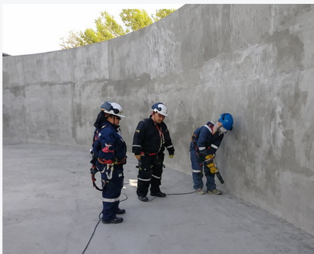
TRABAJO EN RECINTO TÉCNICO
