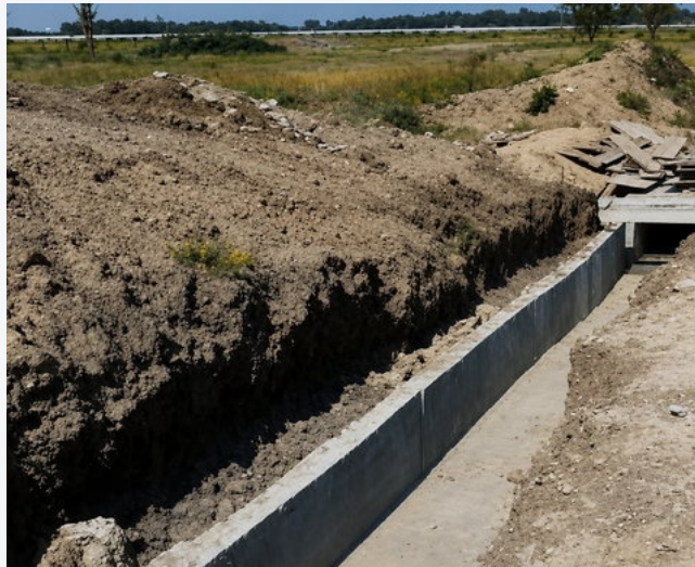
CANALIZACIÓN DE HORMIGÓN
